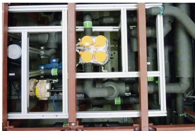
❷ Temperaturkonditioniersystem (-30 bis +120 °C), zweifach vorhanden
